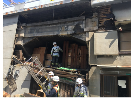
玄関が全面被害を受けた家屋
