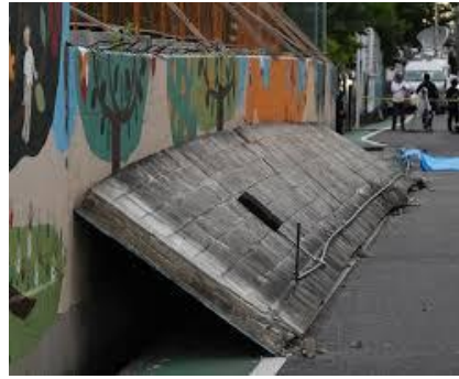
地震により倒壊した小学校の塀
